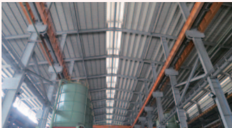
▲ 屋頂上方設置吸氣口
