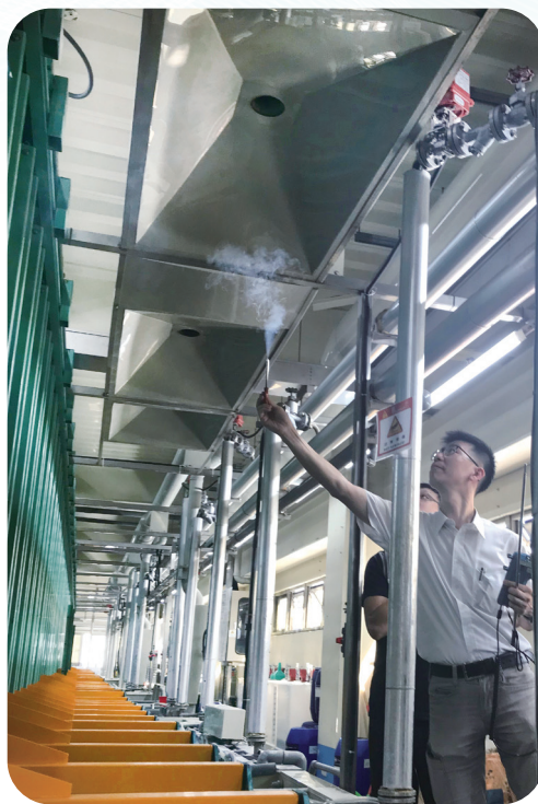
▲ 局部排氣裝置性能測試
