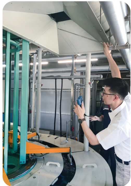
▲ 局部排氣裝置性能測試
